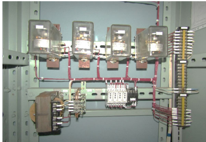
Рис. 7. Шкаф дополнительного контроля включения линий электрообогрева
