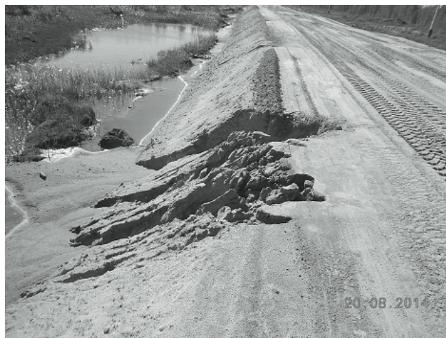
Рис. 5. Подтопление дорожного полотна и эрозия на его откосах
